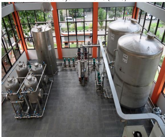
Instalasi Pengolahan Ultrafiltrasi (UF)
