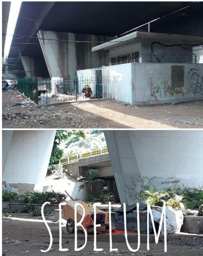
Gambar Flyover Slipi Sebelum Diperbaiki
